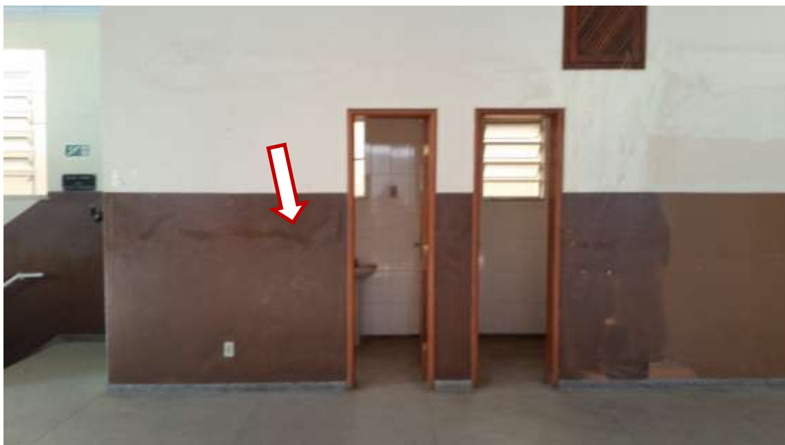
Foto 13 – No segundo andar, parte de parede que será removida para aumento da porta do banheiro que será adaptado para pessoas com necessidades especiais.
