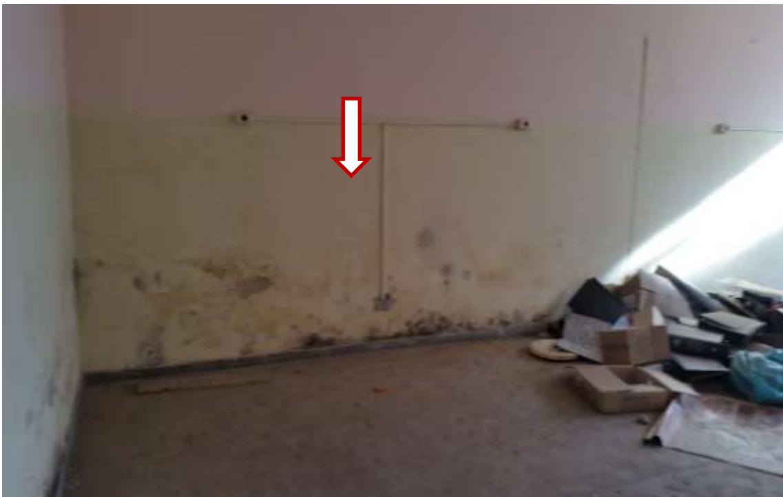
Foto 09 – Foto interna mostrando a situação atual do prédio; podemos ver um início de deterioração da argamassa por conta de umidade ascendente e a necessidade de pintura das paredes. Nas paredes serão instalados os
