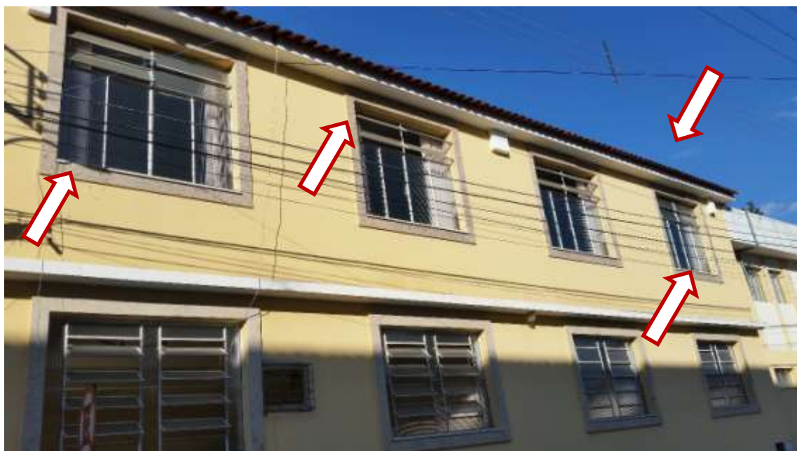
Foto 03 – Foto da fachada lateral, mostrando revestimentos em granito para se recompor e beiral no telhado para instalação de calha.
