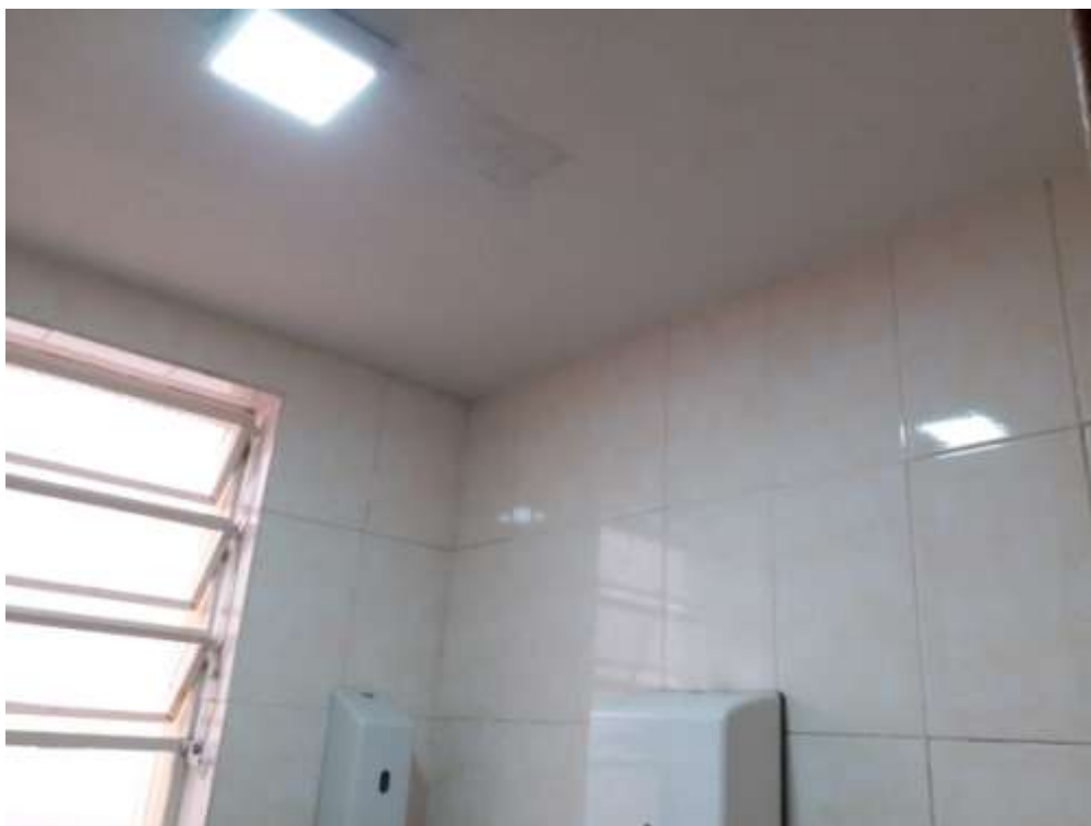
Foto 06 – Foto de outro ângulo das paredes e teto do banheiro.
