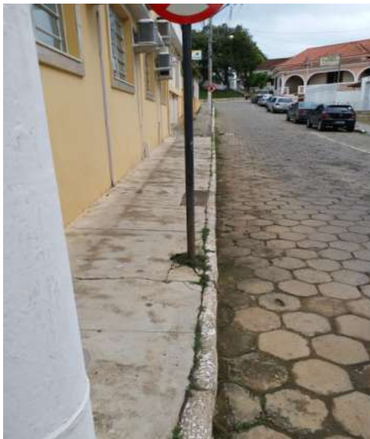
Foto 04 – Foto da calçada lateral. Toda calçada referente ao prédio será reformada.
