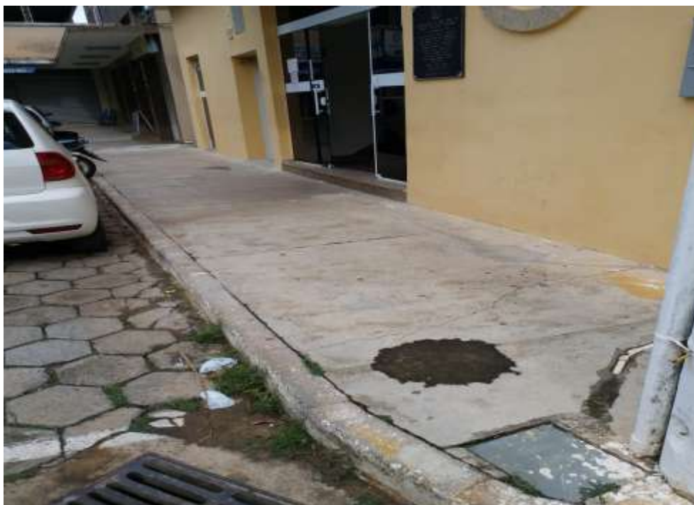
Foto 03 – Foto da calçada da entrada do prédio. Toda calçada referente ao prédio será reformada.
