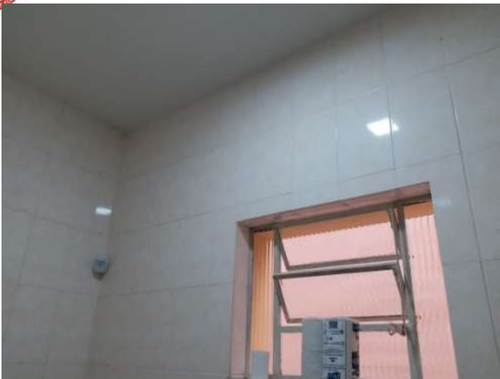
Foto 07 – Foto janela basculante do banheiro. Todas janelas serão trocadas.
