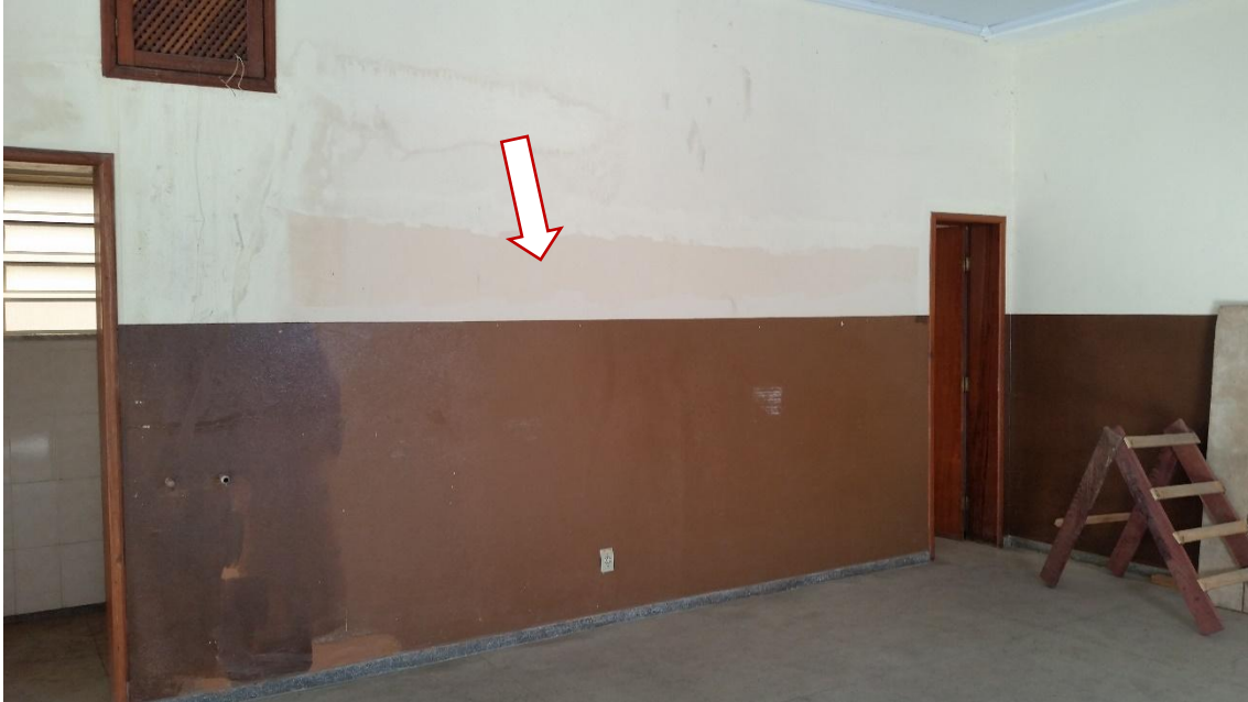
Foto 12 – No segundo andar, vemos parte de parede que será removida para aumento da cozinha.
