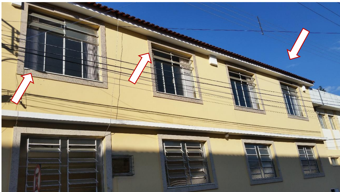
Foto 03 – Foto da fachada lateral, mostrando revestimentos em granito para se recompor e beiral no telhado para instalação de calha.
